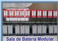
Sala de Bateria Modular
