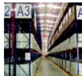
Porta-paletes estruturado na Ebamag Logística
