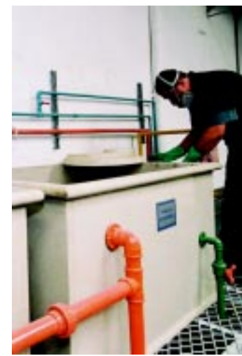
Tratamento de efluentes é fundamental na sala de baterias
