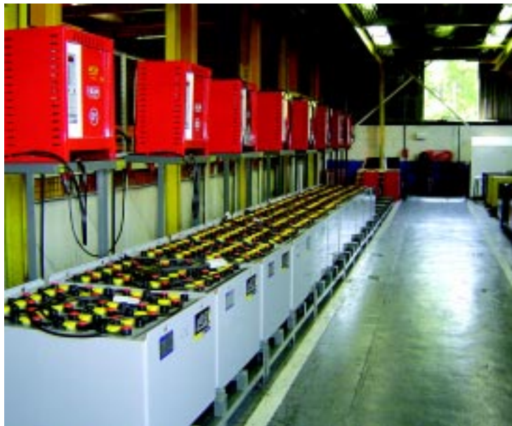
Uma sala de baterias não pode ser construída em local fechado, sem ventilação e desprotegida das intempéries naturais
